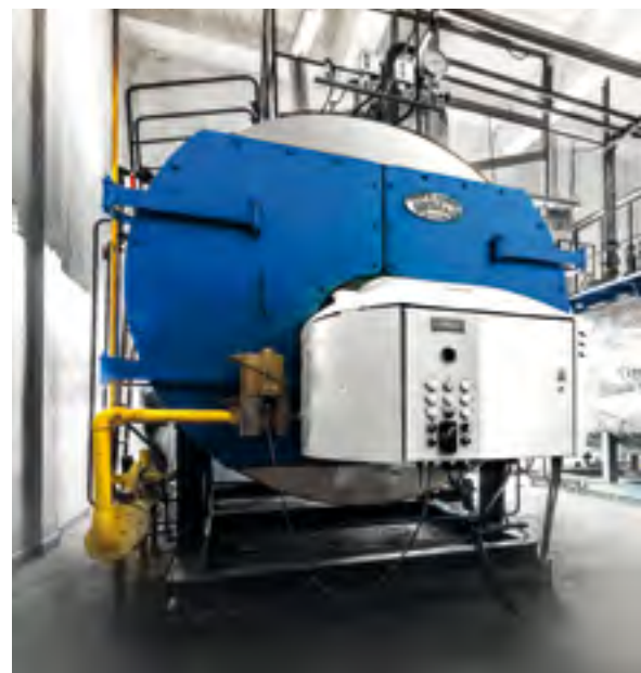
Local technique de chaudière à vapeur
